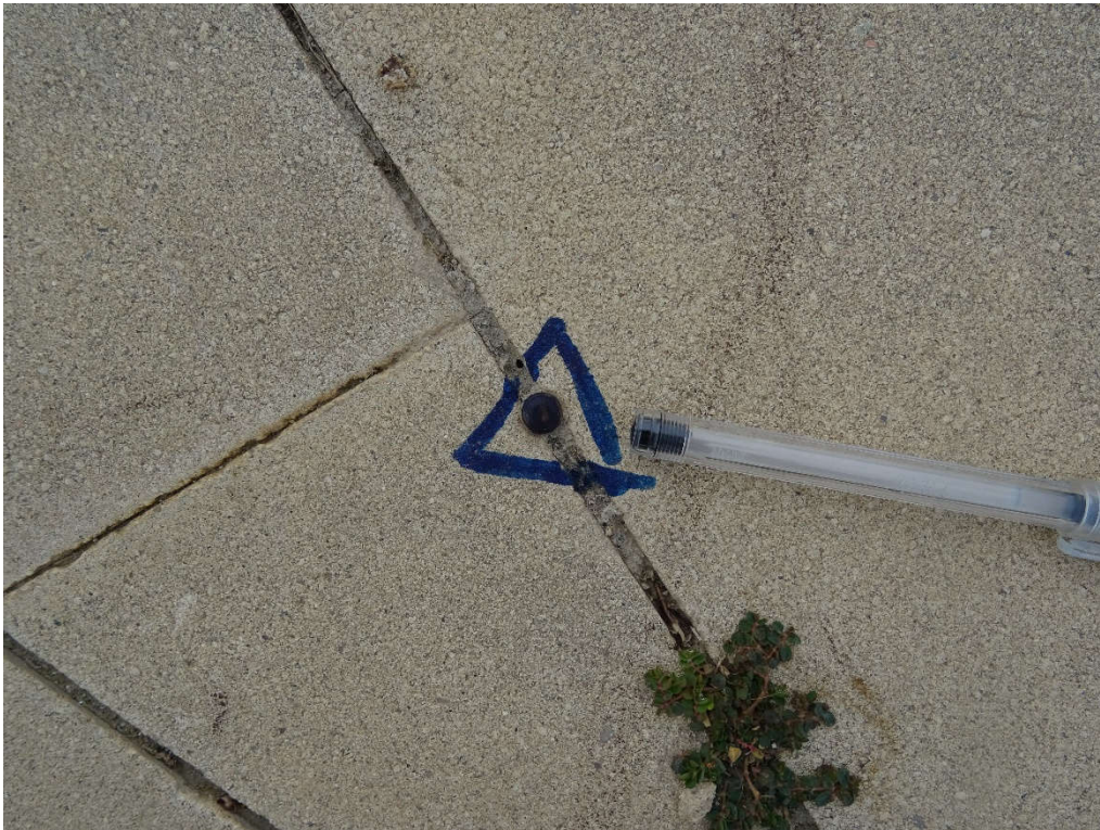
Figura 13: Clavo de acero empotrado en solera utilizado para la señalización ACUAMED 2012
