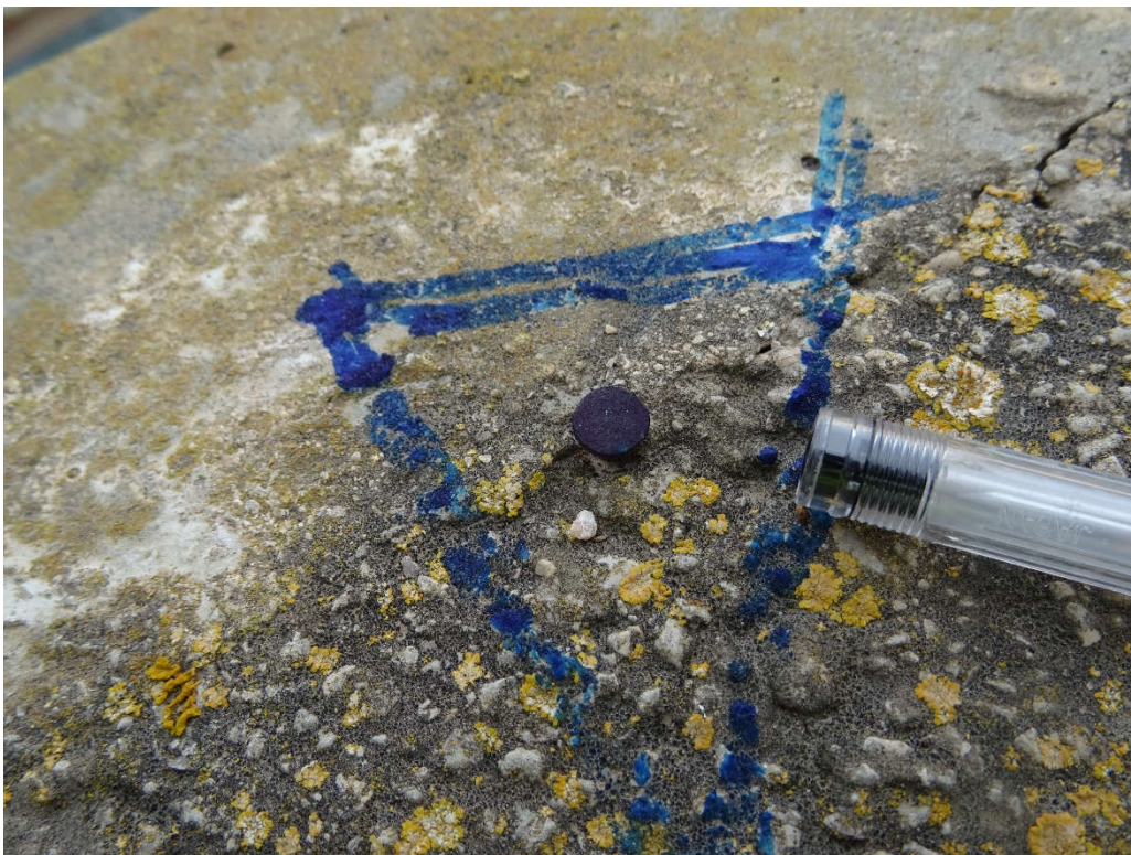
Figura 12: Clavo de acero empotrado en hormigón utilizado para la señalización ACUAMED 2012
