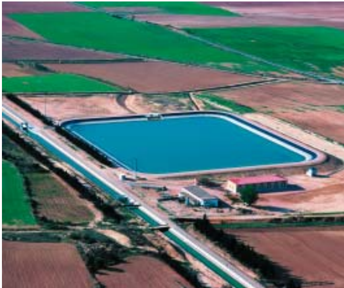
Balsa-Estación de bombeo de Pertusa (Huesca).
