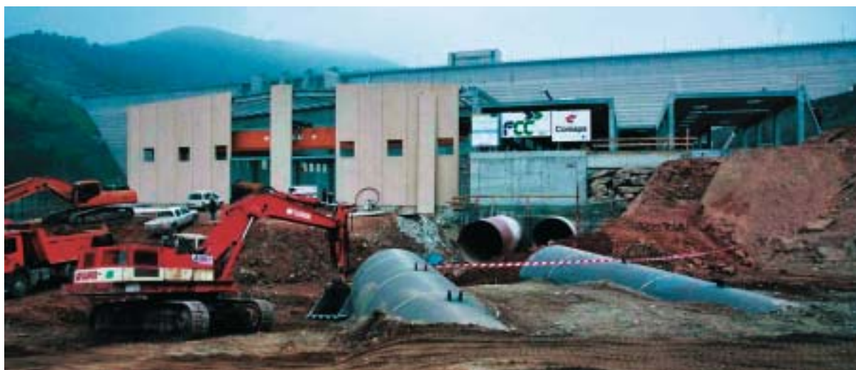
Toma de agua del Embalse de Rialb.
