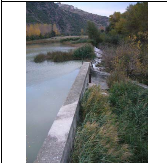
Azud de la central hidroeléctrica de Gallipienzo. Deriva agua por margen derecha para dicha central
