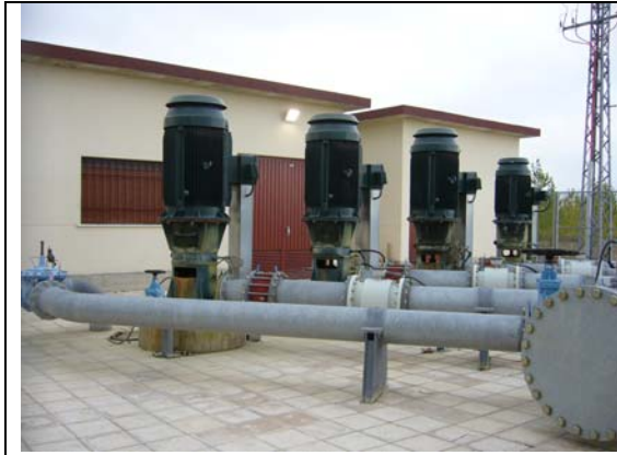
Estación de bombeo en la zona de "El Soto" en el límite del término municipal de Aibar. En esta zona se ha llevado a cabo la concentración parcelaria
