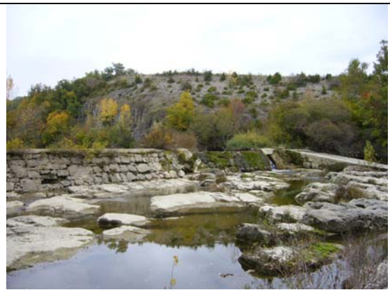
Azud de Navascués. Se utiliza para regadíos de esta zona
