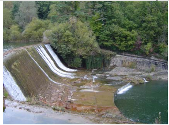
Azud de la central hidroeléctrica de Olaldea II. Deriva agua por margen derecha. Dispone de escala de peces
