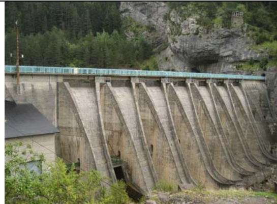
Presa de contraembalse de Ip (0,5 hm 3 ). Sirve para acumular agua que es bombeada en horas valle al Ibón de Ip, para ser turbinada de nuevo en horas punta de demanda
