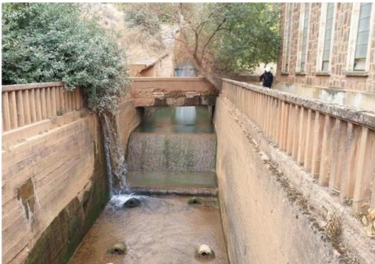
Ilustración 4. Tramo canalizado del barranco de las Anastasias que se utiliza como canal de descarga de la central hidroeléctrica.
